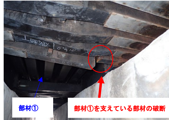
橋梁下面からの伸縮装置損傷状況
