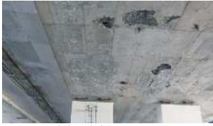
松島高架橋 床版下面 コンクリートの剥離
